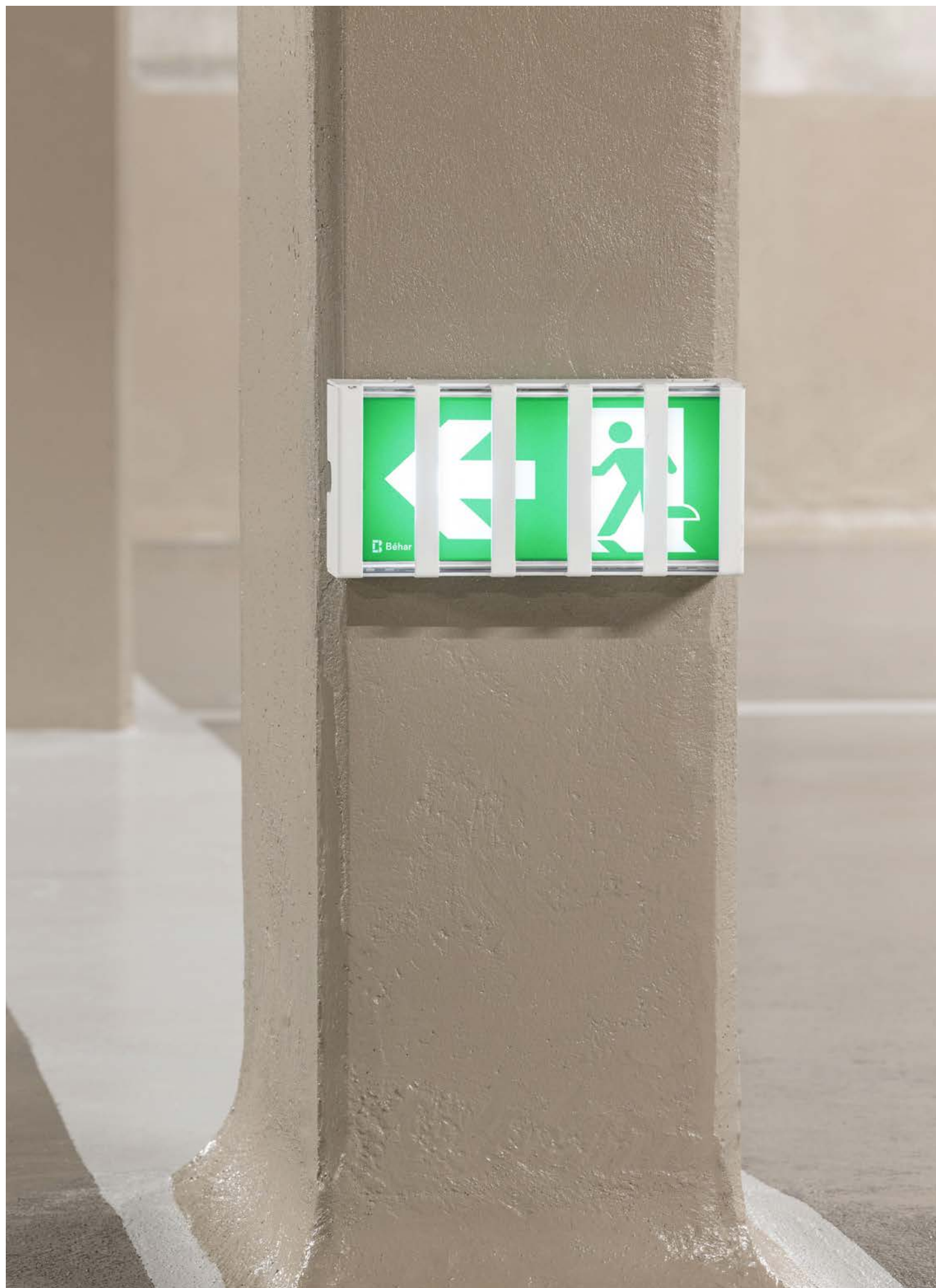
Parking Hôtel Mondrian Bordeaux Les Carmes, Architecture - P.Starck, photo I.Mathie, luminaire série Eclat 2 Grille
